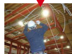
電気配線(ユニット部)
